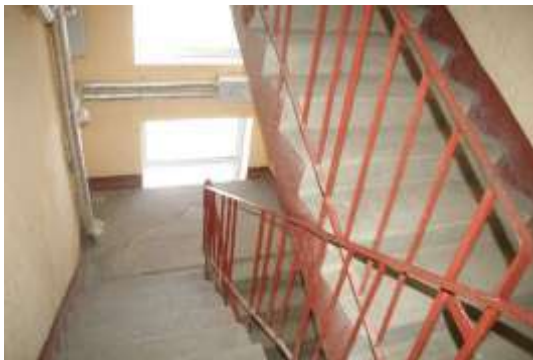
Būve ar kadastra apzīmējumu 1700 002 0062 001, koplietošanas telpa
